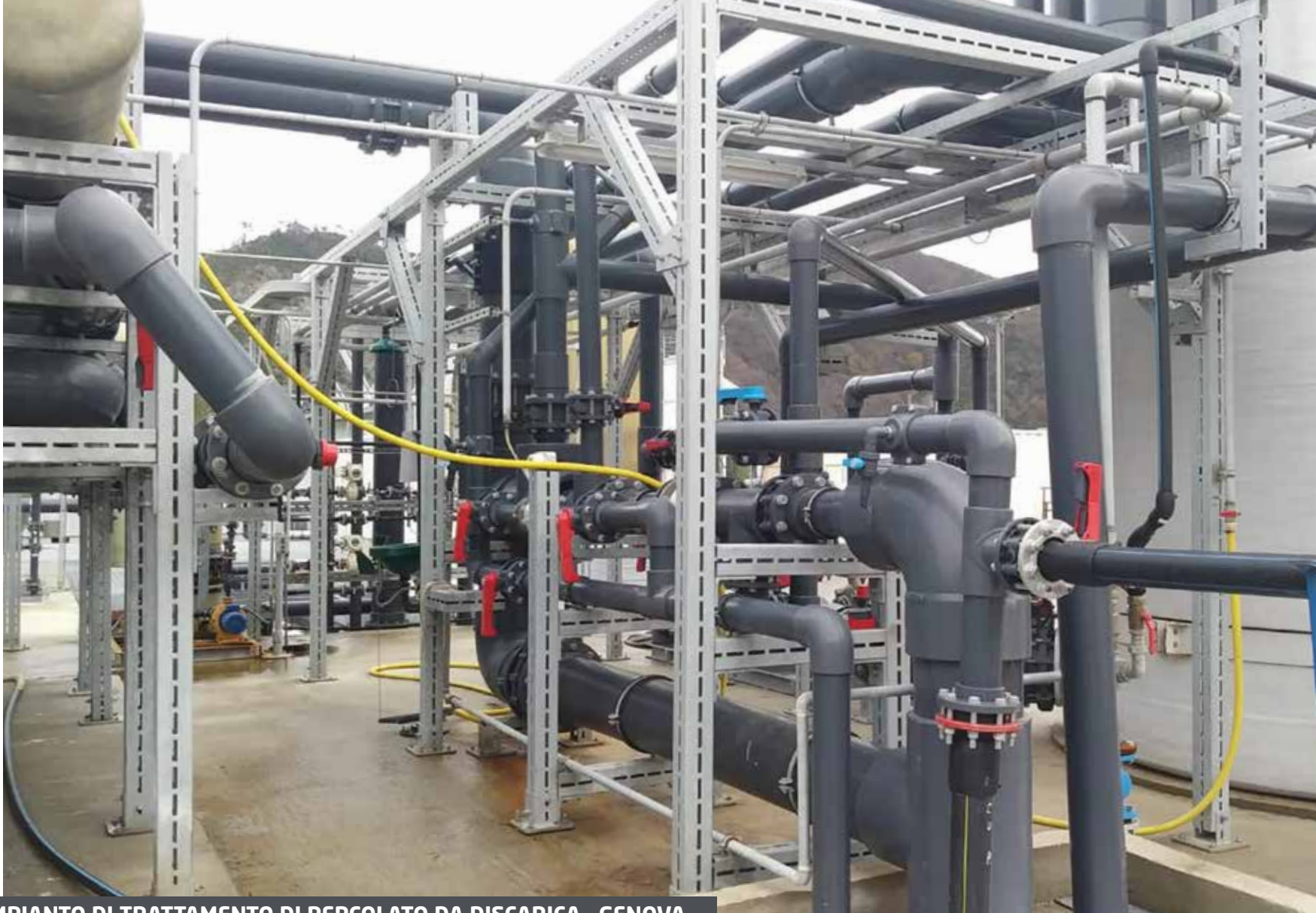
IMPIANTO DI TRATTAMENTO DI PERCOLATO DA DISCARICA - GENOVA
